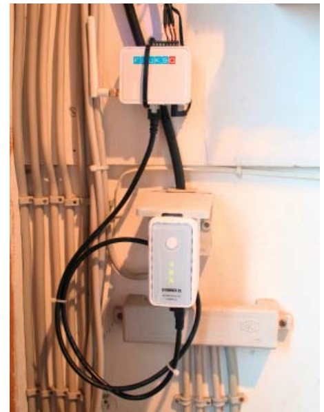
Alternativlösung für die Kommunikation des Flukso mit dem Router: D-Lan-Adapter kommuniziert über die Steckdose und das Stromnetz; Quelle: Privat
